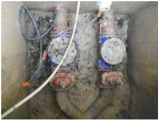
Figure 13 : La chambre à vannes
