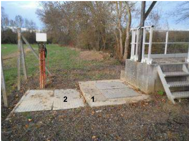
Figure 11 : Chambre à vanne (1), chambre des pompes (2) et boîtier électrique
